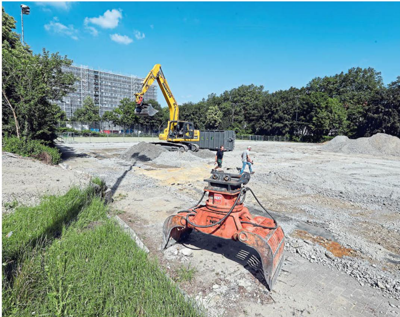
Die Arbeiten für die neue Sporthalle des Helmholtz-Gymnasiums laufen. Neben die Halle kommen neue Sportanlagen. Im Hintergrund ist das Finanzamt Innenstadt zu sehen, rechts hinter den Bäumen ist das Helmholtz-Gymnasium.
